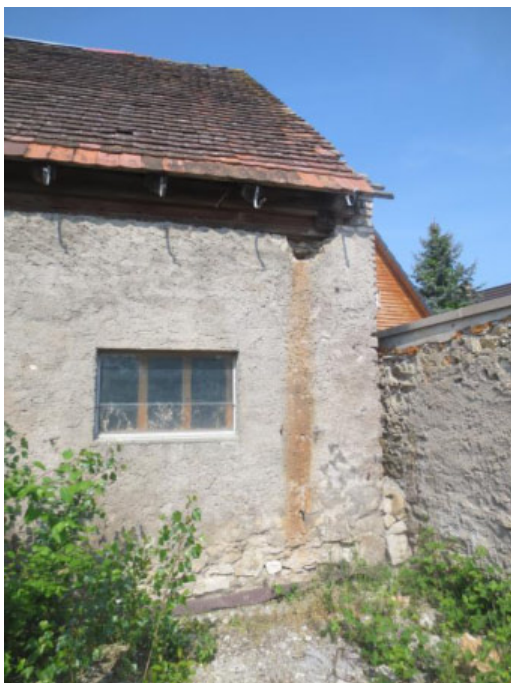
Abb. 4: Nahaufnahme der Scheune (Abstand zum Plangebiet ca. 2 m, Spuren vermutlich von ablaufendem Wasser und nicht von Fledermäusen. Ein Vorkommen von Tieren im Gebäude dennoch nicht auszuschließen.
