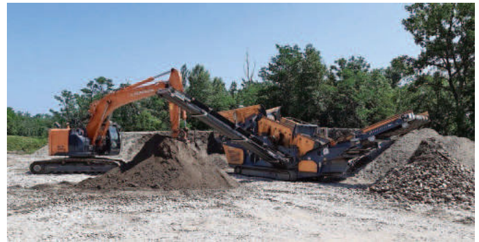
Am Rhein nördlich von Neuenburg arbeiten wieder die Bagger, um mehr Platz für Hochwasser zu schaffen.
