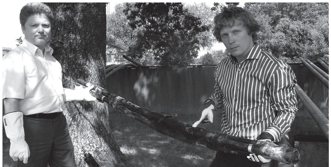
Norman Lübke (Teamleiter Technik Leitung Strom, r. i. Bild) sowie Gerold Bottesch (Fachgruppenleitung Strom) vor einer defekten Muffe auf dem Betriebsgelände der Badenova.
