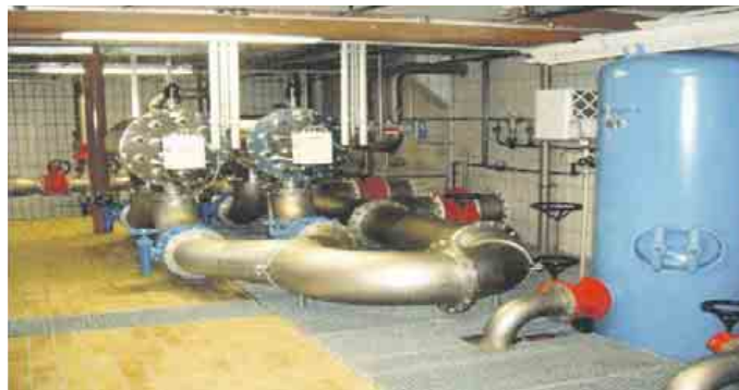
Rohrkeller Pumpwerk mit UV-Anlage
