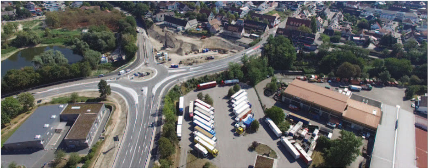
In der Bildmitte lassen sich die Baufortschritte für das Parkhaus am Kronenrain erkennen, und den im Bau befindlichen Kreisverkehr am Stadtpark am Wuhrloch.
