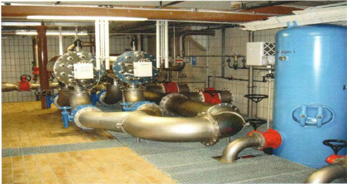
Rohrkeller Pumpwerk mit UV-Anlage
